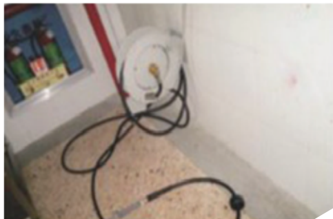
Wysokość instalacji jest zbyt niska i nie ma odzyskiwania. Odzyskiwanie po odwrotnej instalacji.
