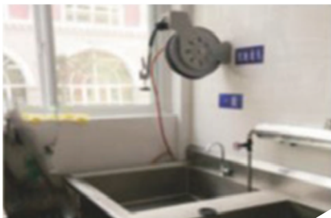
La altura de instalación no es suficiente 1.3-1.6 m, el impacto de fácil de usar colisión.
