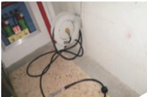
La altura de instalación es demasiado baja y no hay recuperación después de la instalación inversa.
