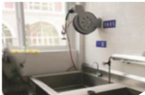
Wysokość instalacji nie jest wystarczająca 1,3-1,6 m, co ma wpływ na kolizję przyjazną dla użytkownika.
